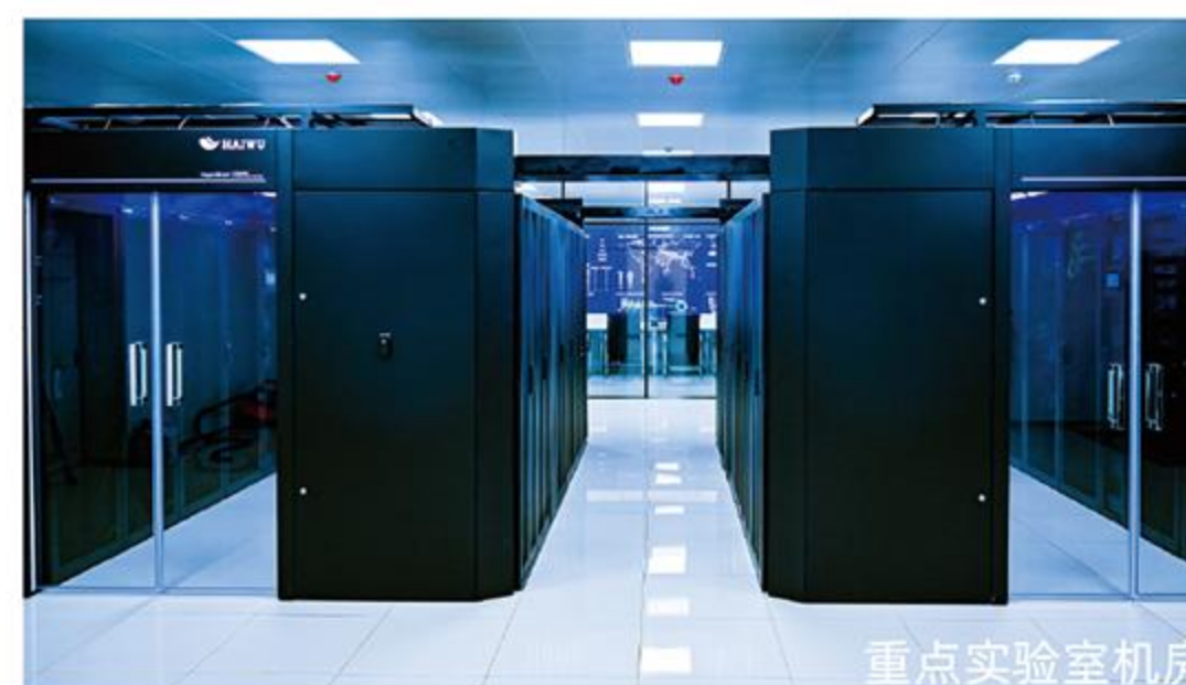
重点实验室机房
